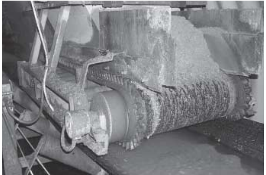
Lavorazione di inerti derivati dal mare, ambiente umido, salino ed aggressivo! La tenuta IP66/67 è un MUST – spesso anche con tenute reingrassabili!
